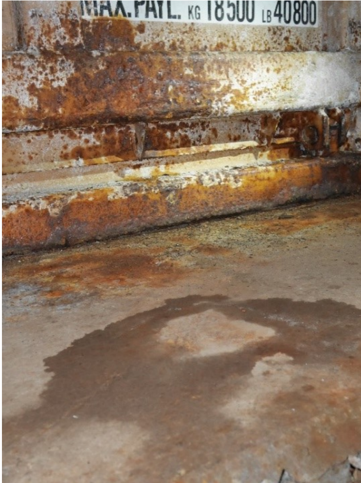
Bilden visar korrosionsangrepp lokaliserade i anslutning till droppande grundvatten.
