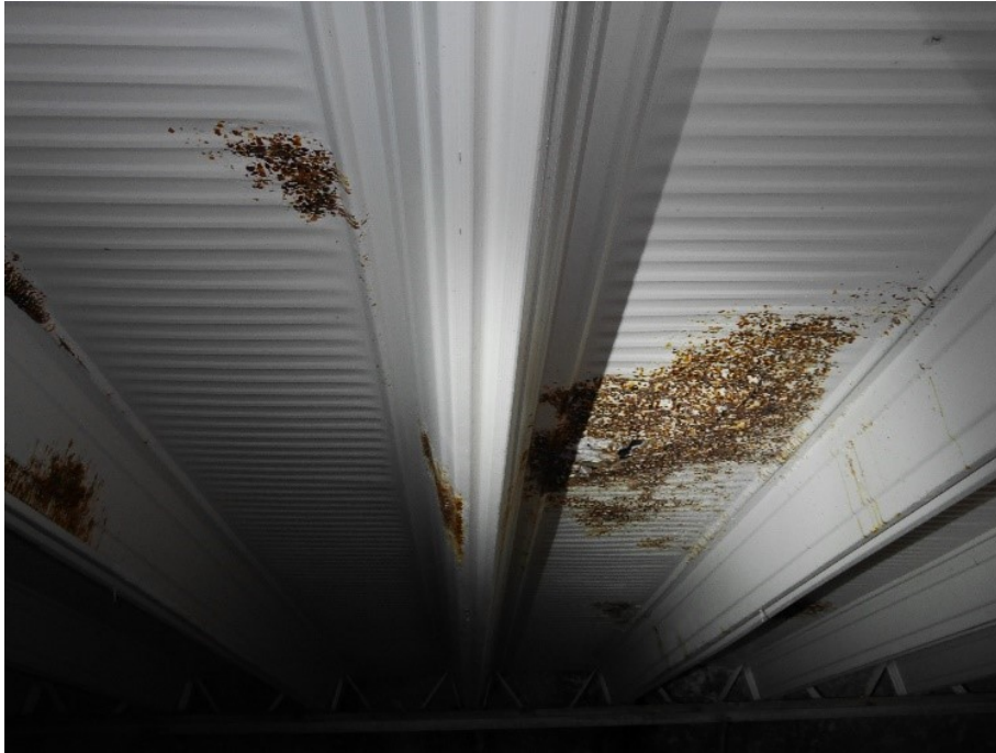
Exempel på hål som uppstått som följd av droppande salt grundvatten på plåttaket.
