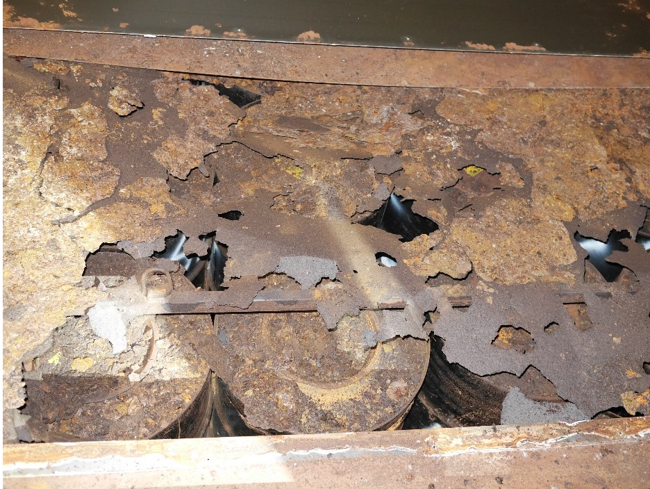
Exempel på halvhöjdscontainer i översta raden där hål i det obehandlade containerlocket uppstått från droppande grundvatten. Även inneremballagen i form av plåtfat är ansatta av korrosion. Avfallscontainern står i den innersta raden och är en av de första som deponerades i 1BLA.
