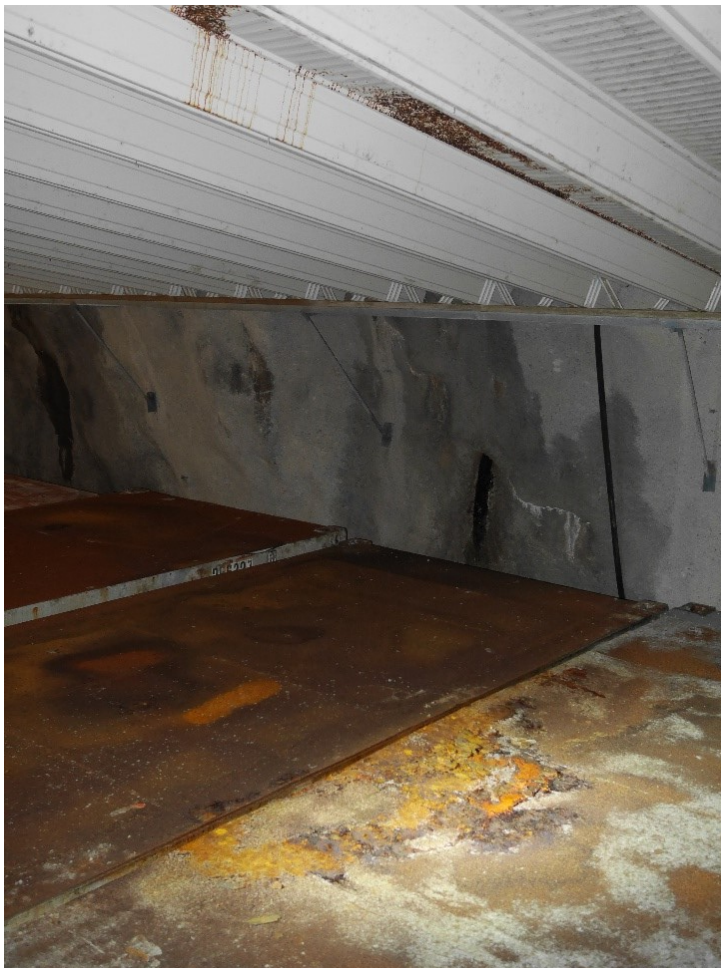
På containerlocken till vänster finns täckplåt installerat. Helhöjdscontainerrama till höger har generellt sätt mindre korrosionsskador
